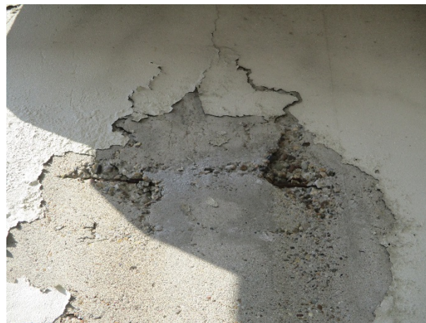
Figuur 8.6: Afgedrukt en losliggend beton met wapeningscorrosie, detail binnenzijde wand A.
