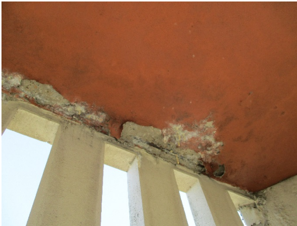
Figuur 8.19: Afgedrukt en losliggend beton met wapeningscorrosie, onderzijde vloer 6 e verdieping.
