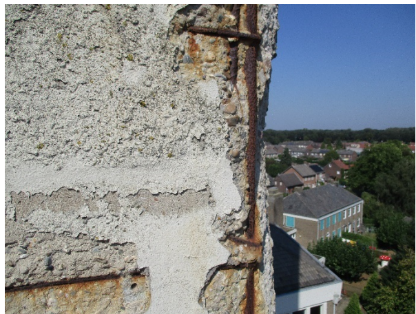
Figuur 8.10: Afgedrukt en losliggend beton met wapeningscorrosie, buitenzijde wand C.
