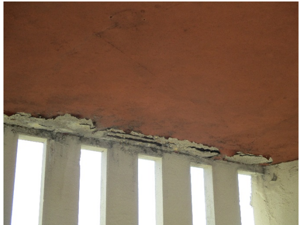
Figuur 8.20: Afgedrukt en losliggend beton met wapeningscorrosie, onderzijde vloer 6 e verdieping.
