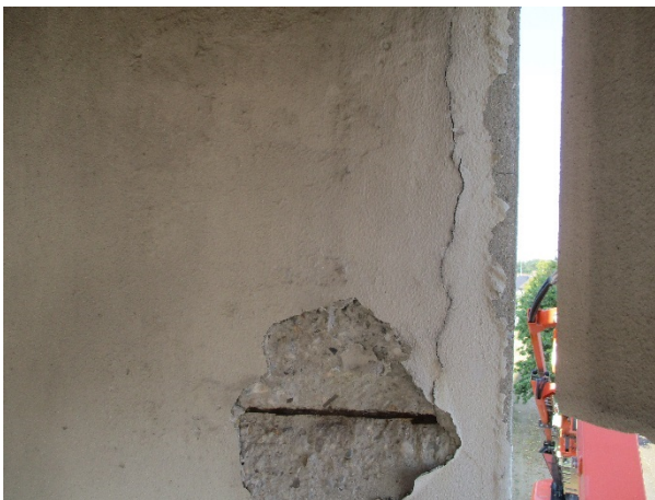
Figuur 8.17: Afgedrukt en losliggend beton met wapeningscorrosie, binnenzijde wand E.
