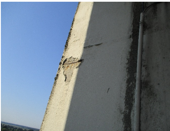
Figuur 8.5: Afgedrukt en losliggend beton met wapeningscorrosie, binnenzijde wand A.
