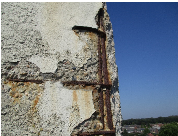
Figuur 8.11: Afgedrukt en losliggend beton met wapeningscorrosie, buitenzijde wand C.
