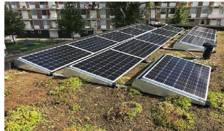
Zonnepanelen en sedumdak
