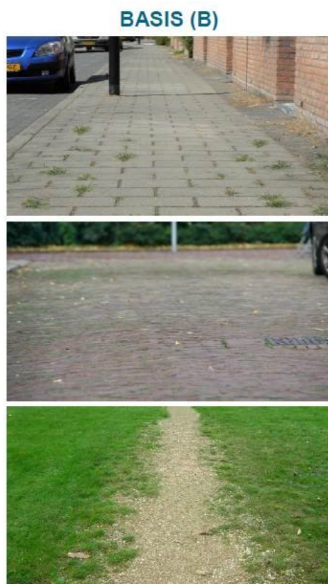
Fig. 3: vastgesteld onderhoudsniveau verhardingen (schouwboek)
