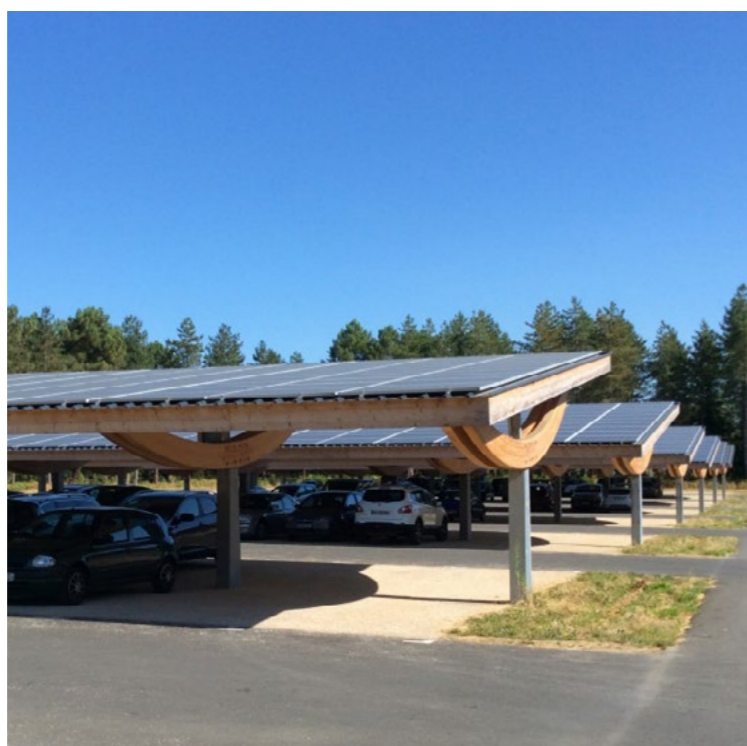
Op parkeerplaatsen bieden verhoogde zonnepanelen een uitkomst, auto's staan droog en in de schaduw
