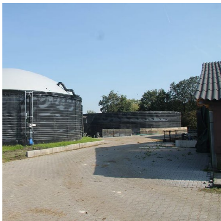
Kleinschalige biogasinstallatie gekoppeld aan een boerenerf op het bouwblok. Voorbeeld: Energie Coöperatie IJskoud (Noord Deurningen).
