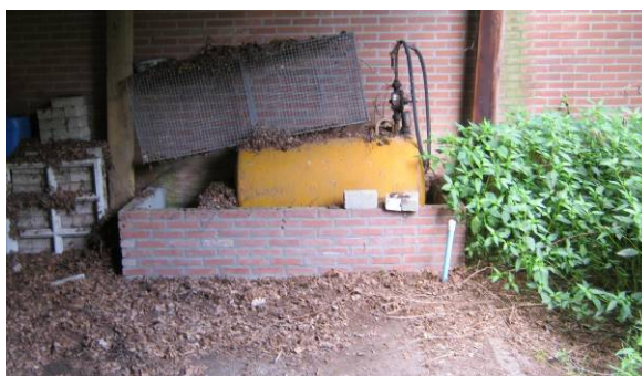
Foto 4: Bovengrondse tank (diesel)
