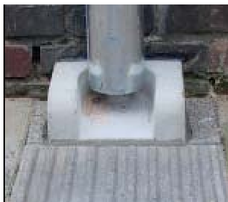
Figuur 7: regenpijp eindigend boven de grond
