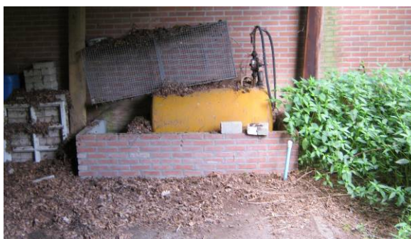
Foto 4: Bovengrondse tank (diesel)
