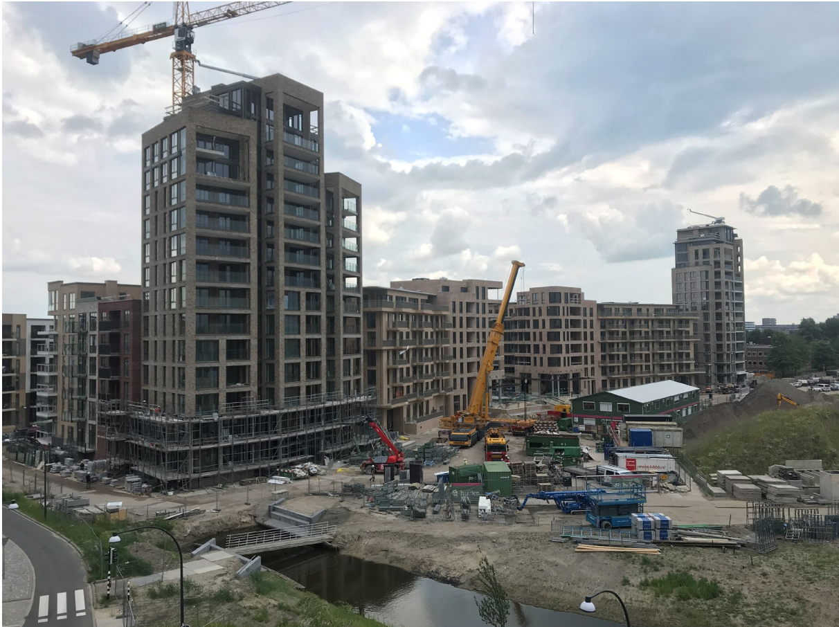
Afbeelding 2: Bouwwerkzaamheden medio 2021 parkblokken 22 en 23 Holland Park en start aanleg park in volle gang.
