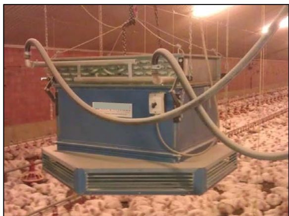
Eén van de twee indirect gestookte warmteheaters
