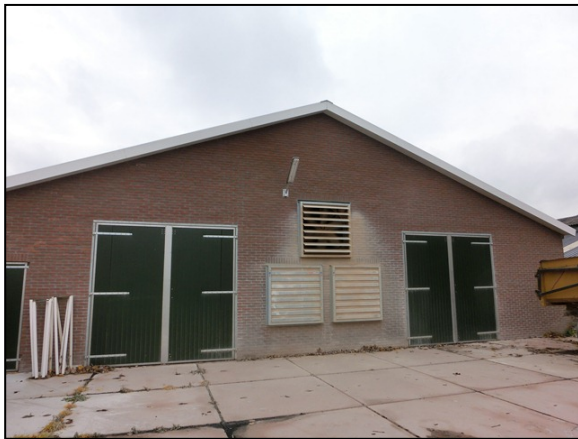
Achtergevel met drie ventilatoren
