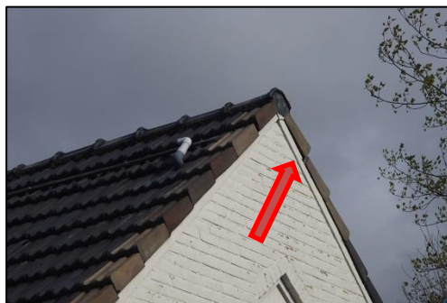
Overhangende dakpannen met ruimte.
