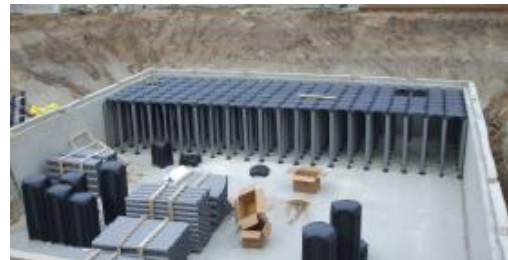
Bron: Waterbergingskelderreferentieprojecten Waterblock B.V.
