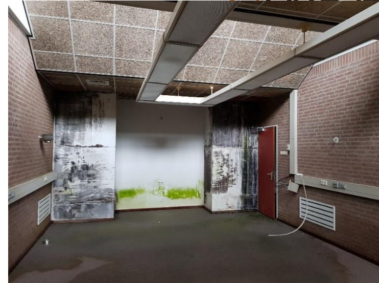
Figuur 66. Impressie zaal met systeemplafonds, waterschade.
