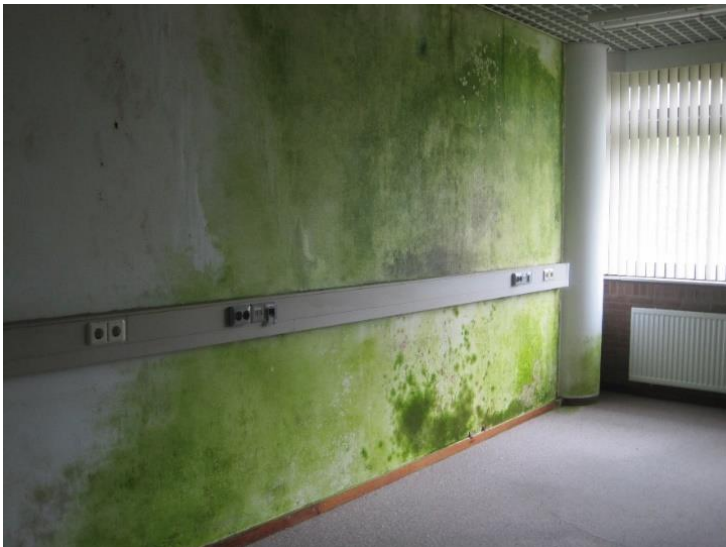
Figuur 67. Impressie kamer met waterschade.
