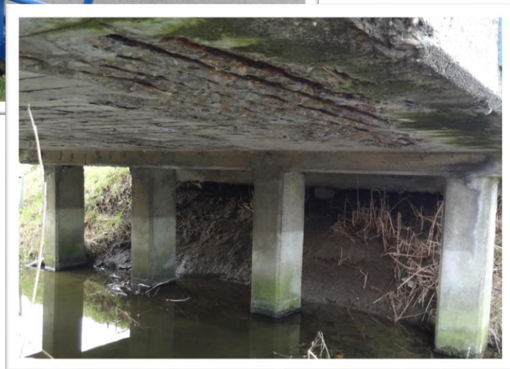
Foto 2.6, ogenschijnlijk is de brug helemaal in orde. Bij inspectie onder de brug blijkt dat de brug in zeer slechte staat is. Na inspectie is direct aslastbeperking opgelegd.
