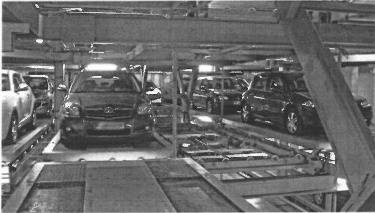
Figuur 8: Mechanische parkeergarage met schuifpuzzel systeem
