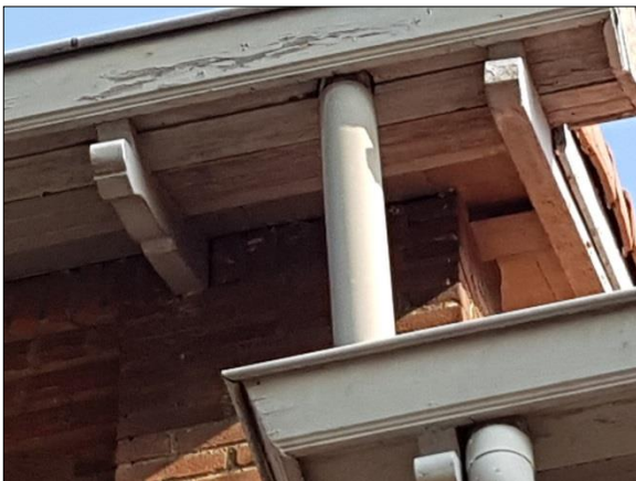
Figuur 9. Versleten dakbetimmering
