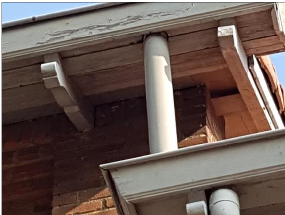
Figuur 9. Versleten dakbetimmering
