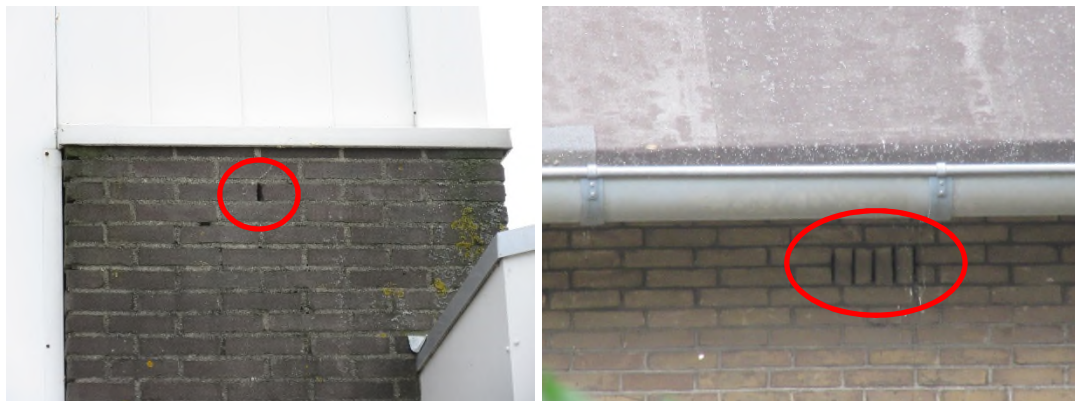
Figuur 6.4. Impressie spouwmuurgaten bedrijfspand IDA Foundation.
