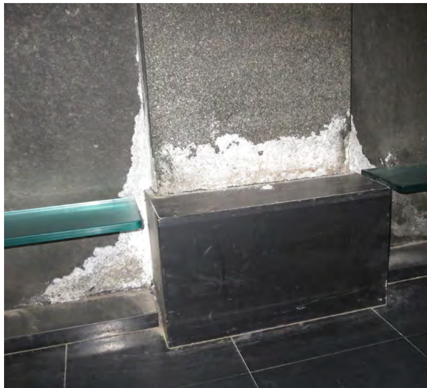
Zoutproblemen in Grote Aquarium zaal, huidige situatie
