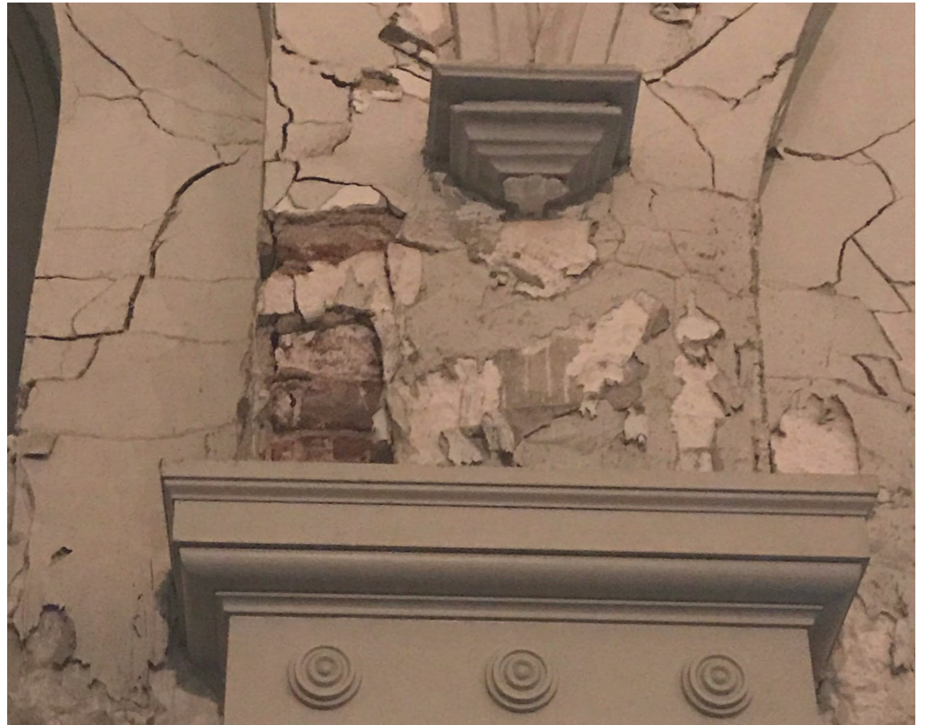
Scheurvorming door zoutaantasting in de Grote Aquariumzaal, huidige situatie
