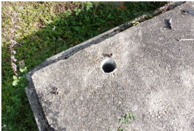
Luchtpijp in uiterste hoek kelder
