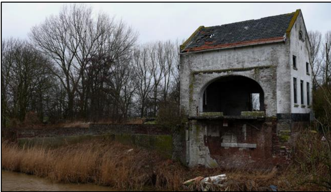
Afbeelding 3: vervallen gemaal vanaf zuidzijde
