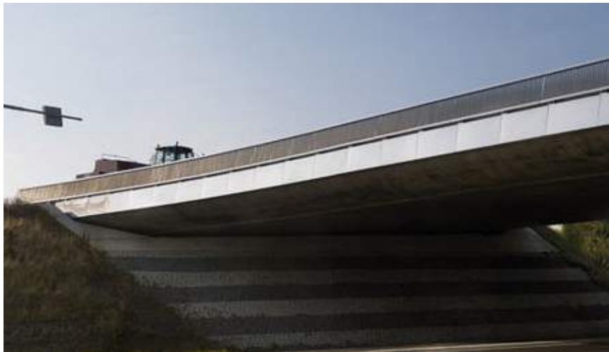
Afbeelding 5.9 Oplegconstructie weggewerkt in het talud van de aanlanding
