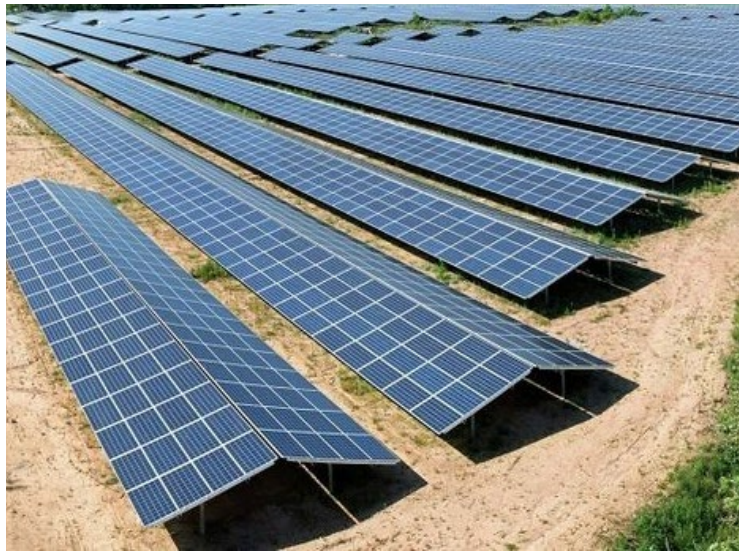
Afbeelding 32. Zonnepanelen (oost-west) opstelling met beheerpaden (gras)
