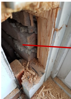
Figuur 1: luchtsponw tussen kolom en penant
