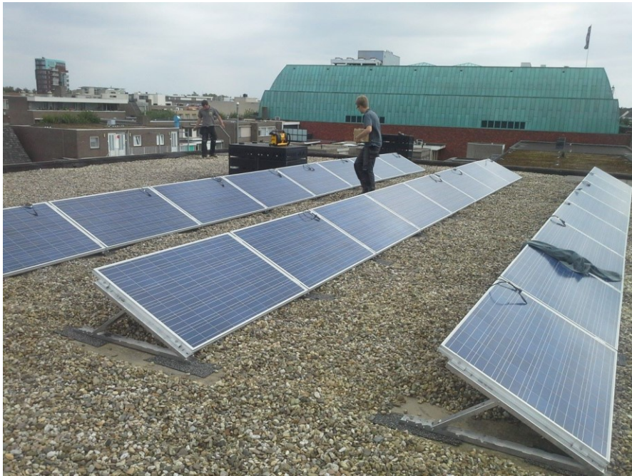
Figuur 5: Zonnepanelen op het dak van een bedrijf in het centrum van Uden
