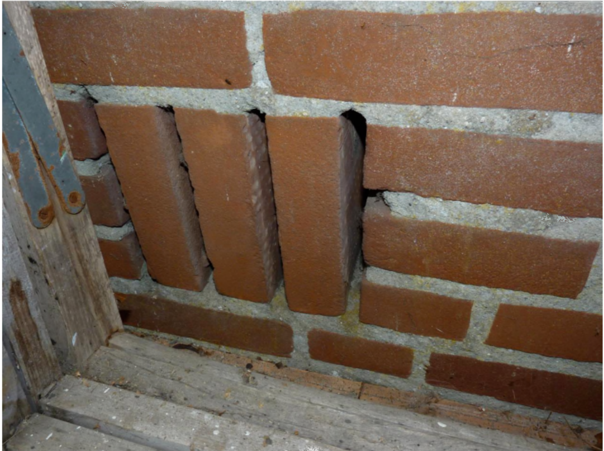
Ventilatie-rooster vlak boven de grond
