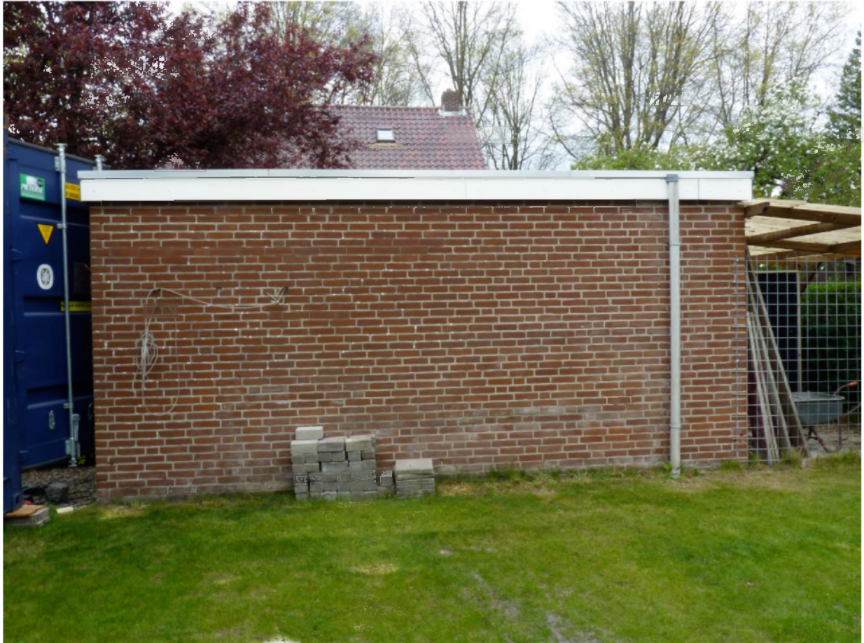
Blinde muur van bijgebouw 2 zonder ventilatievoegen
