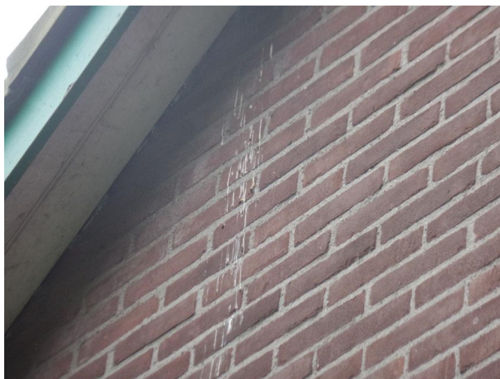
Figuur 10 en 11: Mestsporen van vleermuizen, die wijzen op gebruik van de woning als vleermuisverblijf
