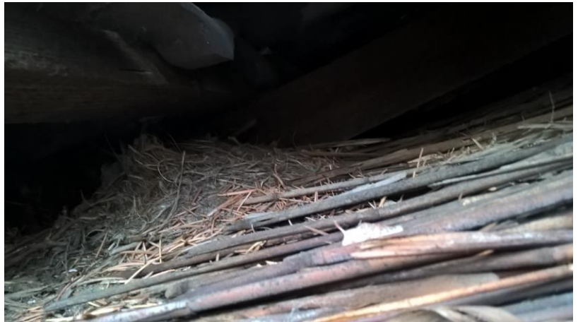
Figuur 8: Mussennest tussen de dakpannen en het vlooiendak
