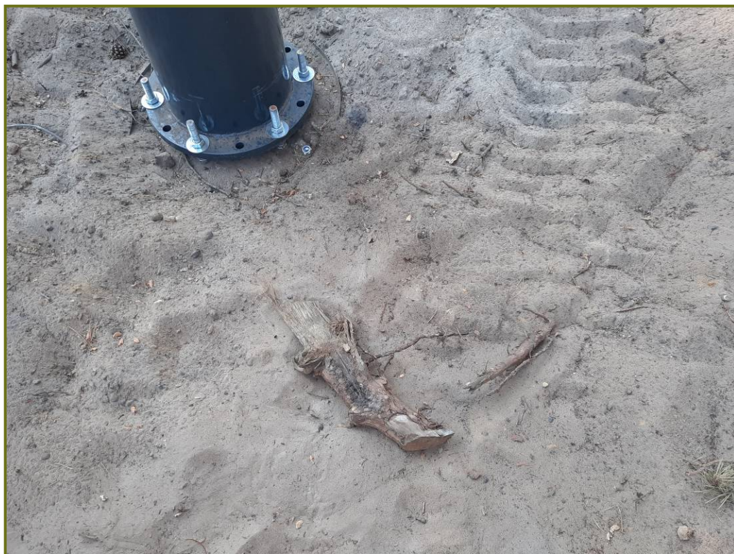
Afbeelding 8. Verwijderde wortels door de bevestiging stalen constructie
