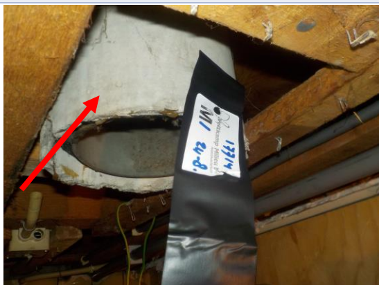
Foto 1 | Foto voor bron Ventilatiekokers
