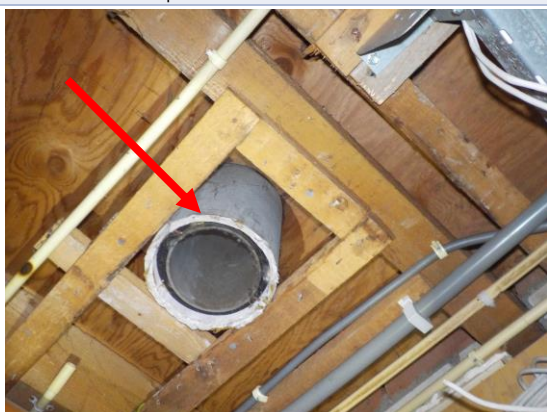
Foto 3 | Foto voor bron Ventilatiekokers
