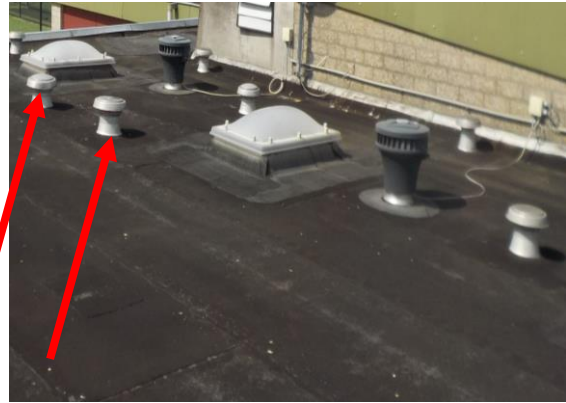
Foto 6 | Foto voor bron Ventilatiekokers
