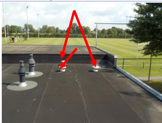
Foto 4 | Foto voor bron Ventilatiekokers
