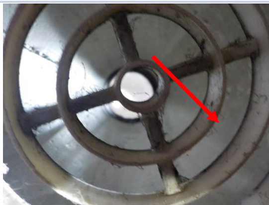
Foto 2 | Foto voor bron Ventilatiekokers
