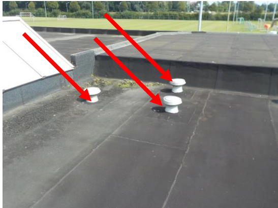
Foto 5 | Foto voor bron Ventilatiekokers
