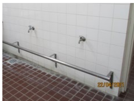
Verouderde tegelvloer kleedruimtes
