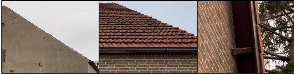
Figuur 4 De dak- en kantpannen en overstekken van de woning op de planlocatie sluiten overal nauw aan en bieden geen mogelijkheid voor vleermuizen om toegang tot de dak- of spouwruijnte te krijgen.
