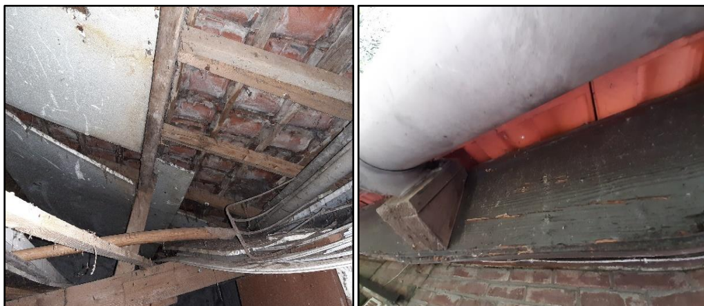
Figuur 4: Links grote delen van het dakbeschoot in schuur A ontbreken. Rechts: De dakpannen van woning A sluiten direct aan op houten balken aan de gevels.
