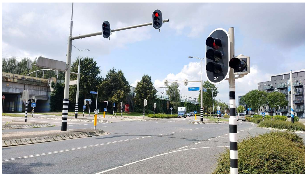
Afbeelding 6. Verkeersregelininstallatie op de kruising Stationsweg/Karel Doormnanlaan.
