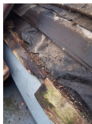
De folie is onder de goot aangebracht en niet in de goot, waar door afkomend water in de constructie terecht komt
