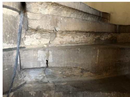
Veel scheurvorming aanwezig in de treden van de zandstenen spiltrap.
