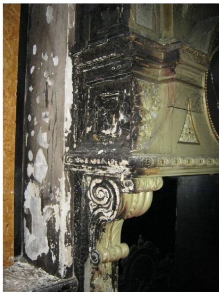
Houtsnijwerk aan de linkerzijde van de schouw moet worden vervangen.
