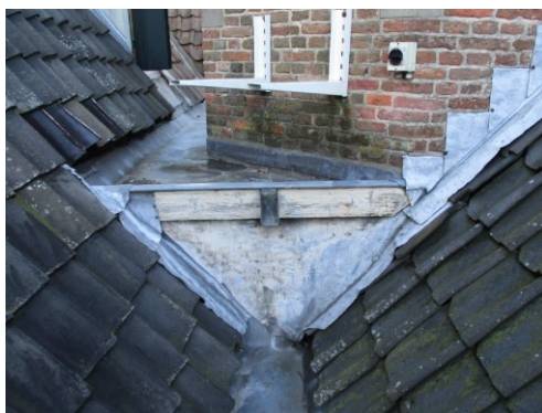
In slechte staat verkerende goten en aansluitingen
