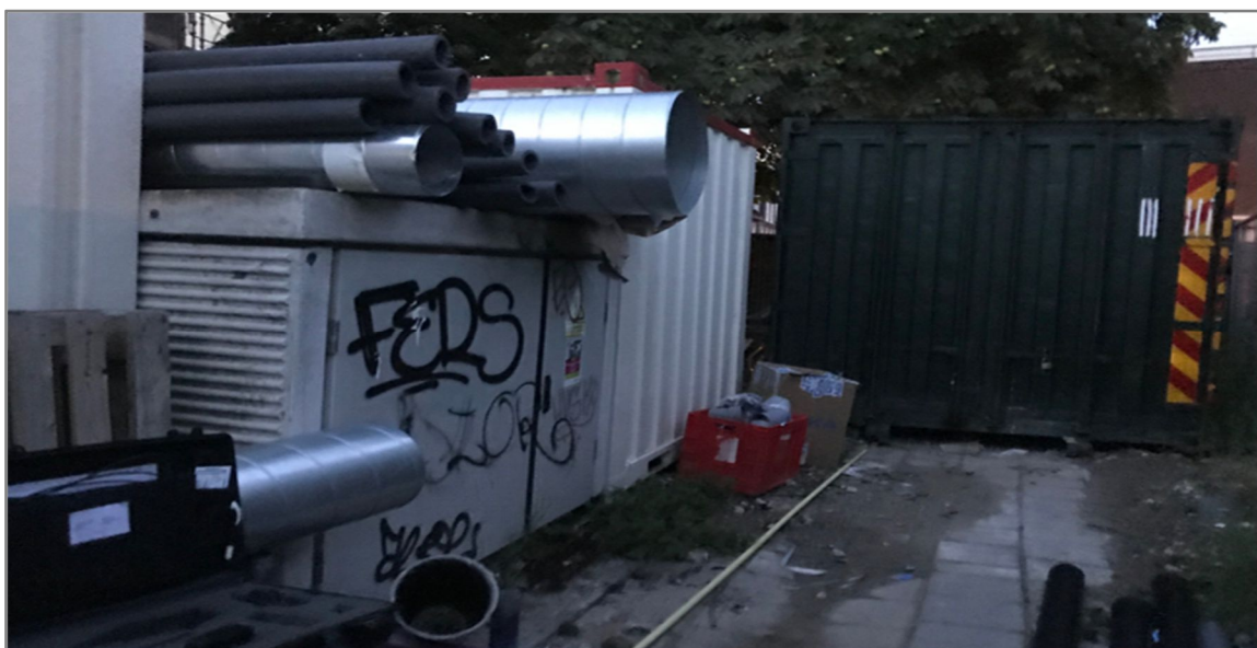
Figuur 2.3 Transformatorkast Hoogstraat te Zwolle
