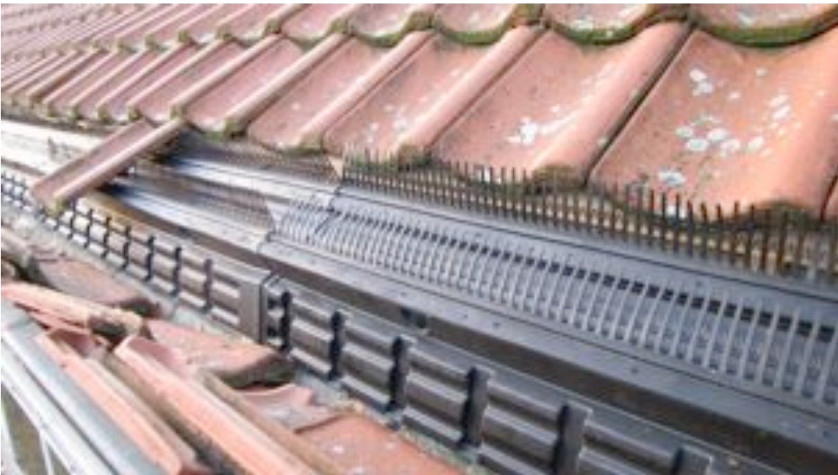
Afbeelding 3: Voorbeeld vogelvide onder dakpannen.
